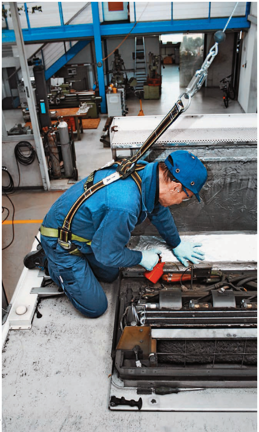
Bei Absturzgefahr sind entsprechende Sicherungsmassnahmen nötig.
